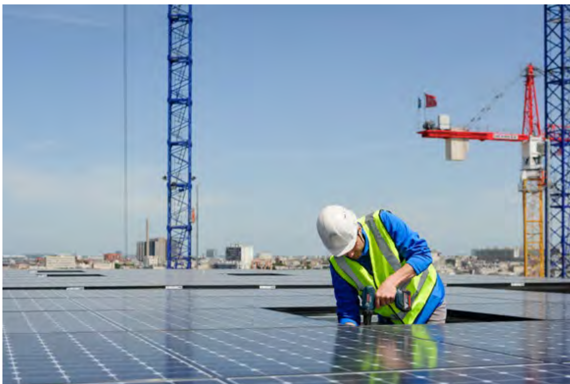
Intervention d'un technicien sur un panneau photovoltaïque sur le chantier de la ZAC Clichy-Batignolles © Terra/MTE
