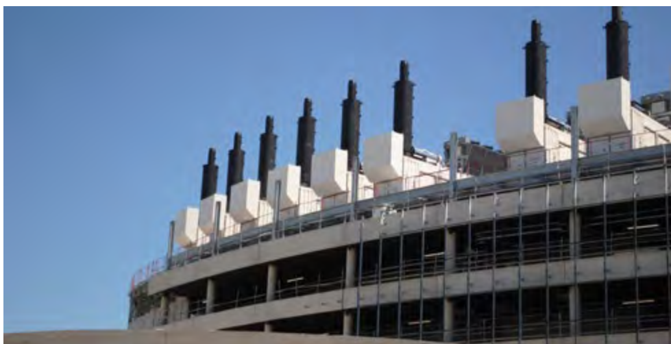
Cheminées du data center PAR 8 de La Courneuve (93) © MRAe-Idf
